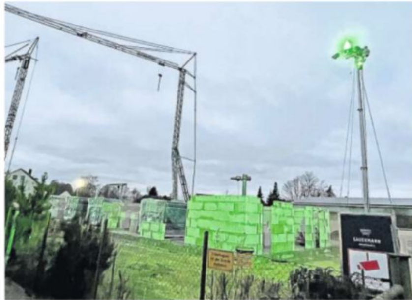
Auf der Baustelle in der Bleekestraße wird die Fläche ab den Abendstunden grün ausgeleuchtet.
